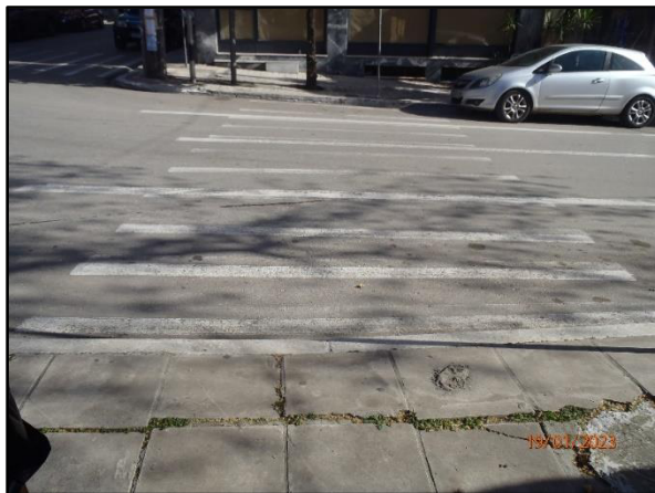
Εικόνα 2: Διάβαση πεζών στο κέντρο Στυλίδας χωρίς ράμπα.
